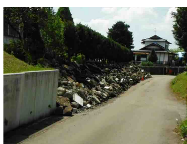
(h)空石積擁壁の崩壊 (西原村)
