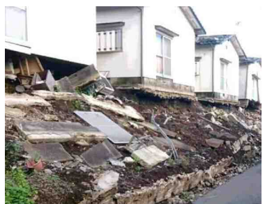
(g)練石積擁壁の倒壊 (益城町)
