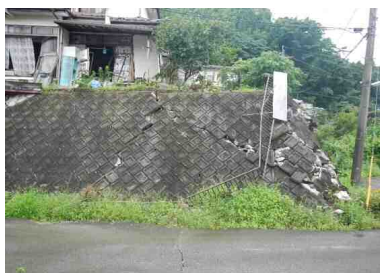
(d)練石積擁壁のコーナー部の崩壊 (益城町)
