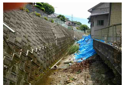
(c)練石積擁壁の横クラック (益城町)
