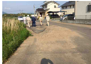
(a)道路の噴砂・亀裂
