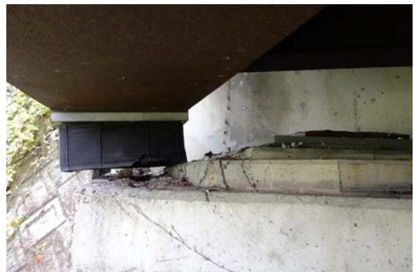
写真-1 熊本地震により破損したゴム支承 (大切畑大橋 A2 橋台のゴム支承, 2016.5.13 撮影)
