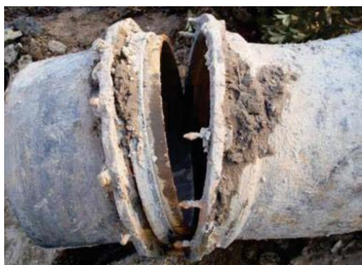
図-4 非耐震継手 (K形継手) の離脱 2)
