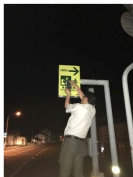
写真8 暗幕除去表示確認
