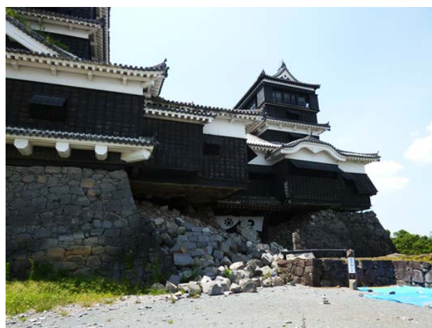
写真-3 大天守と小天守の間の石垣の被害
