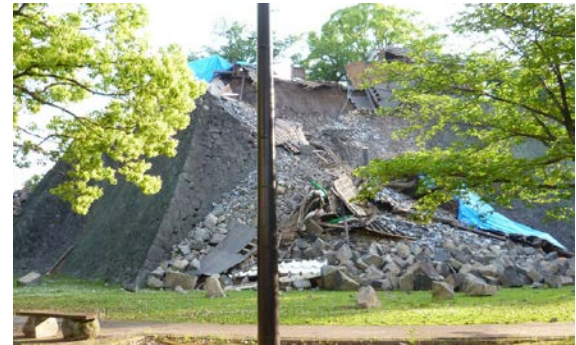
写真-6 北面の崩壊断面
