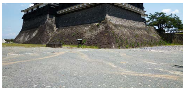
写真-5 天守周辺地盤の凹凸現象
