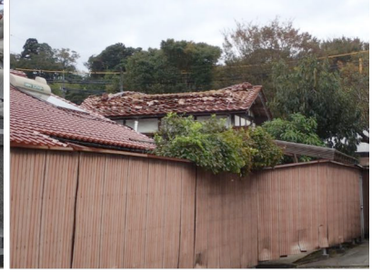
(c) 民家の被害(屋根瓦の落下)
