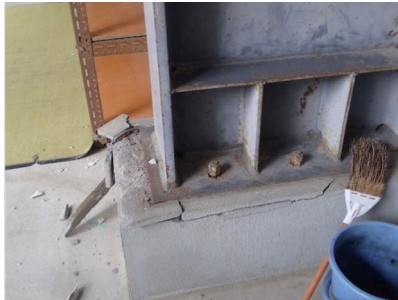
(d) 東中学校体育館の基礎の破壊
