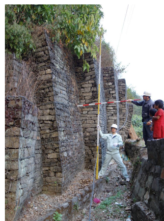
写真-1 アラニコ・ハイウェイ沿線被害調査における蛇籠擁壁の被害例
