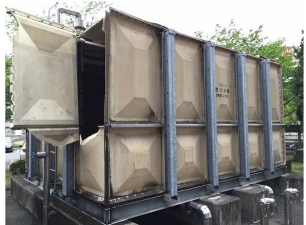
写真-1 隅角部上部側ならびに天井部が破損した事例 (FRP タンク) (熊本市南区)
