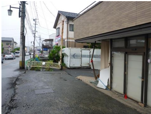
写真-1 液状化による地盤沈下
