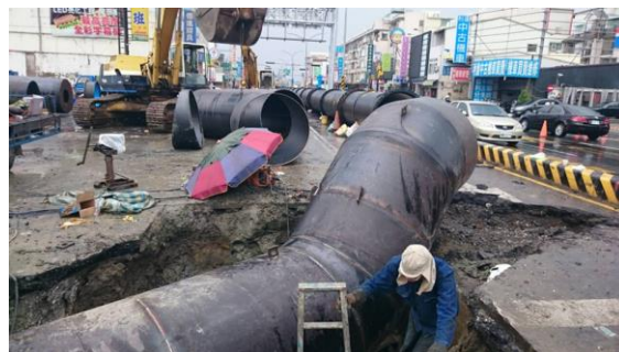
写真 - 1 \Phi 1350 mm のダクタイル鉄管による地上仮配管 1)
