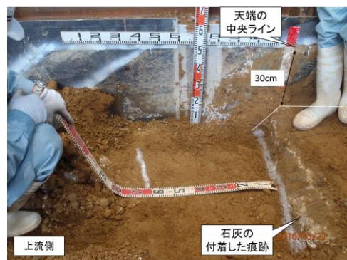
(b) シート側天端中央石灰到達状況
