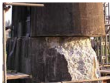
写真-1 新潟県中越地震で被災した魚野川橋梁14P橋脚 3)
