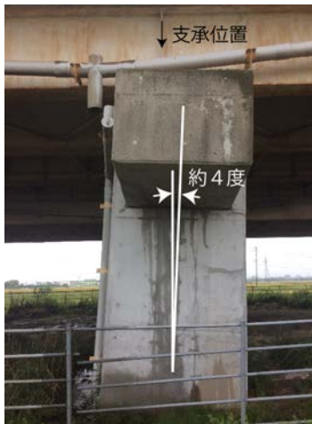
写真-22 R C柱の傾斜 (5月9日撮影)
