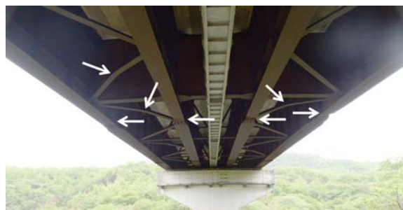
写真-11 俵山大橋の桁部の座屈損傷
