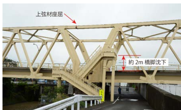
写真-5 横江大橋の橋脚沈下に伴う被害
