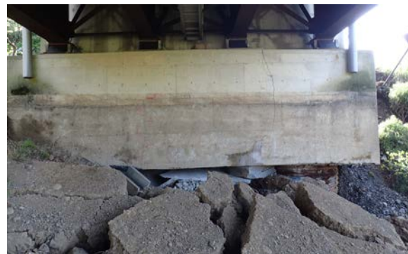
写真-9 俵山大橋の橋台周辺地盤の変状
