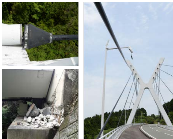
写真-8 桑鶴大橋の損傷状況
