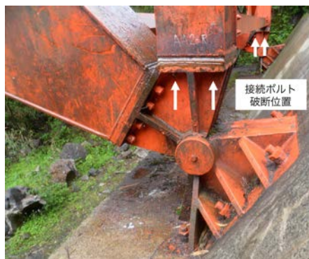
写真-14 南阿蘇橋のアーチ基部支承と鉛直材を繋ぐボルトの破断（写真は地震後溶接による補修後）
