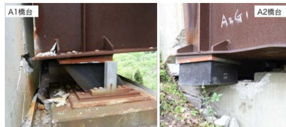
写真-10 俵山大橋のゴム支承の逸脱
