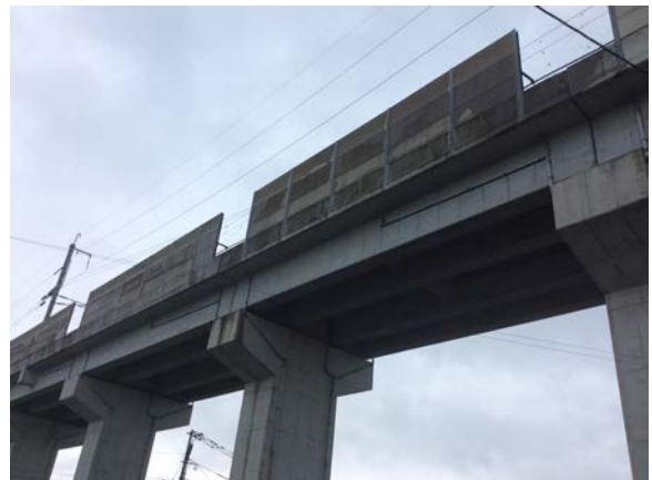
写真-3 九州新幹線十五社高架橋の防音壁の落下
