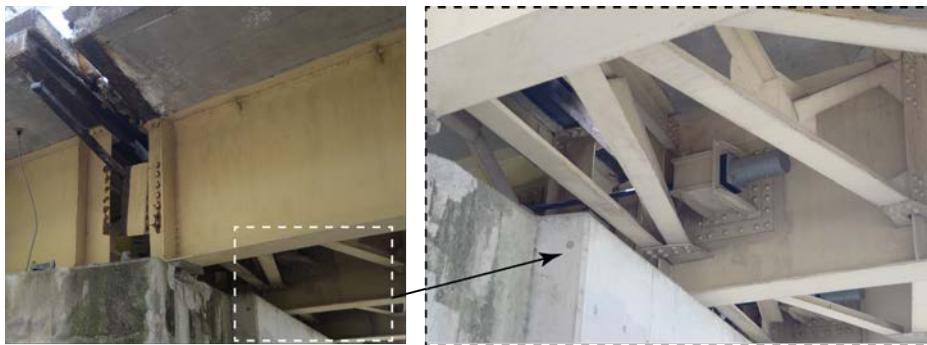
(ii) 桁連結板・支承破壊による隣接桁間の開きと桁間連結ケーブル(P20)
