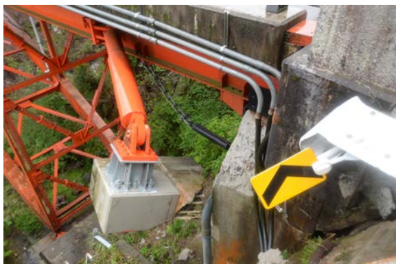
写真-15 南阿蘇橋の制震ダンパー取付部の破壊
