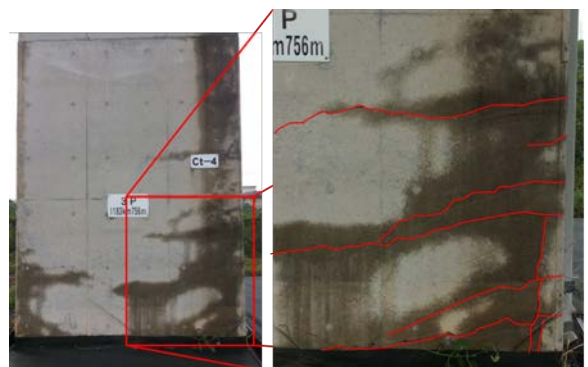
写真-4 九州新幹線十五社高架橋の単柱橋脚曲げ損傷
