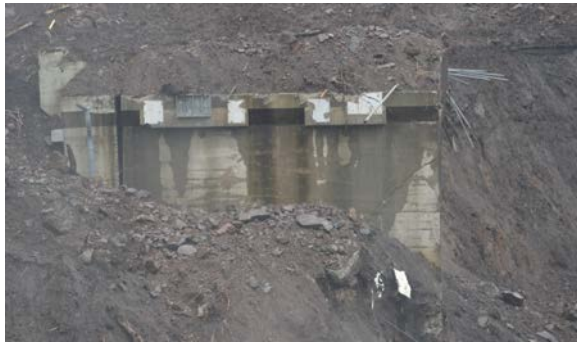
写真-12 流出した阿蘇大橋の橋台部
