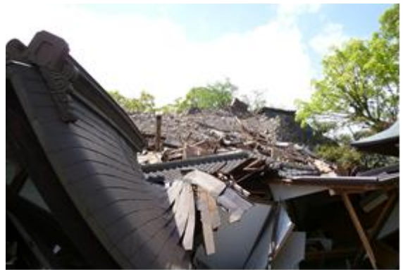
写真 1 熊本城東側・熊本大神宮付近の被害状況
