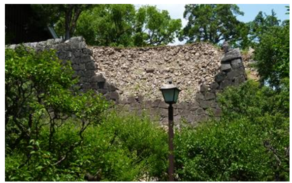
写真6 中央南面 数奇屋丸二階御広間東横の石垣崩落
