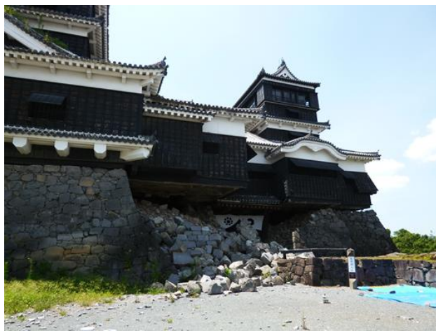
写真10 大天守と小天守の間の石垣の被害
