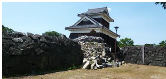
写真8 西側 戌亥櫓東側の被害
