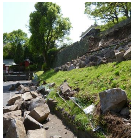
写真 2 東側・稲荷神社付近の被害状況
