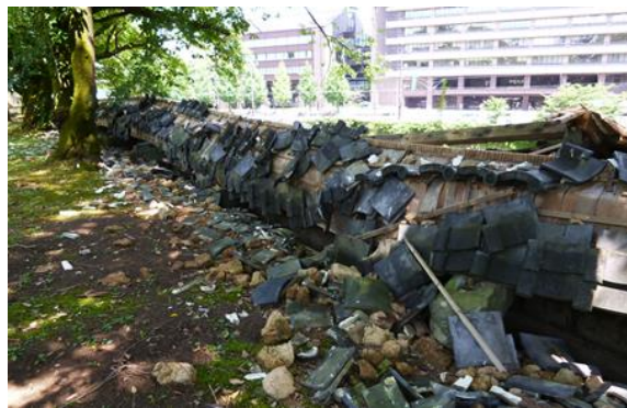
写真4 南側・長塀（損傷区間：東側）
