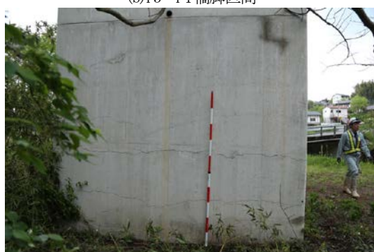
(c) P2 橋脚基部に発生した曲げひび割れ
