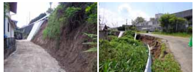
①斜面下部の崩壊土砂の撤去 ②斜面上部の崩壊
