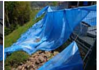
②構造物の被害
