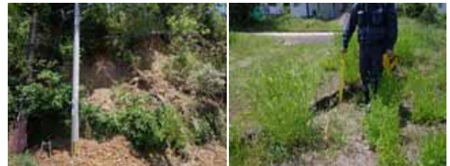
①表層すべりによる崩壊
