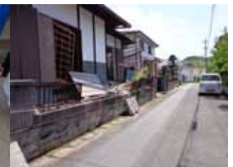
④地盤変状による塀の崩壊
