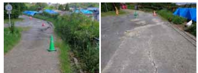
⑤路肩の沈下 ⑥進行性クラックの状況
