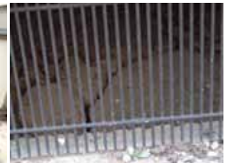
⑥建物地盤内のクラック
