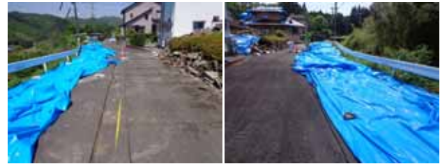
①道路斜面の滑動 ②道路の沈下・段差
