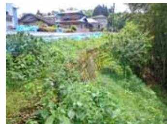
③擁壁のはらみ
