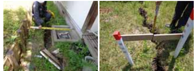
③建物周辺のクラック
