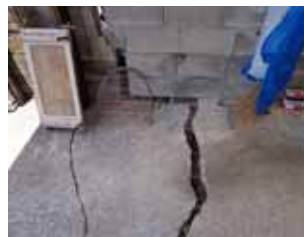
③クラックによる沈下・段差
