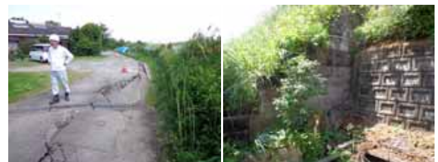
③斜面上部の道路の沈下・陥没 ④住宅背後斜面の崩壊
