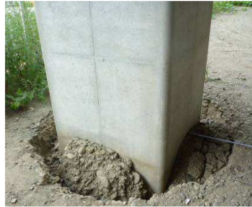
図-7 新耐震基準で設計されたRC高架橋周辺地盤の陥没状
