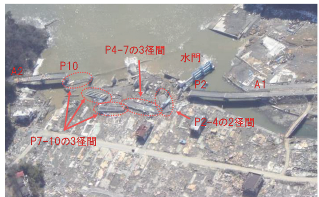
図-1 歌津大橋の被災状況（2011.3.19 東北地方整備局撮影）
