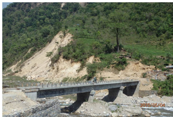
写真9 大規模な斜面崩壊（震源の北約2.5km）
