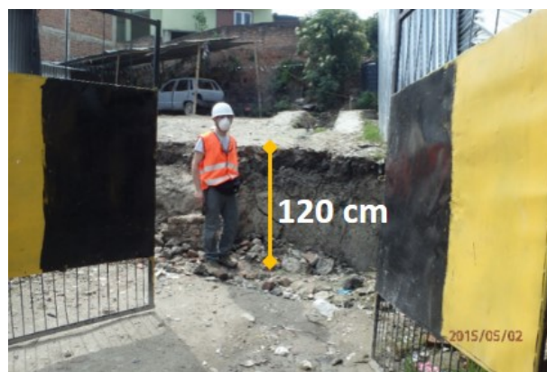
写真2 Araniko Highway周辺の住宅地で確認された地盤の段差
