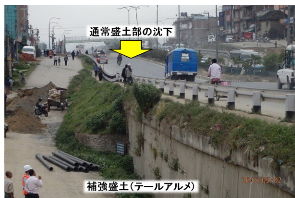
写真1 Araniko Highwayの道路盛土の変状（奥：通常盛土，手前：補強盛土）
