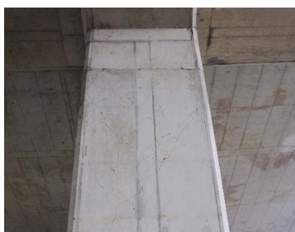
(d) 損傷度Cの被害
