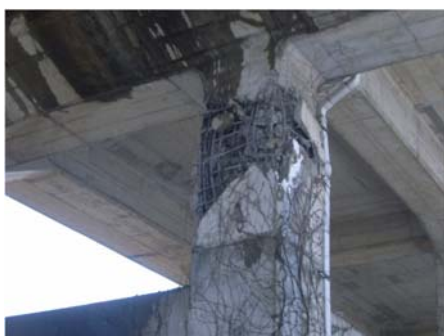
(c) 損傷度B2の被害
