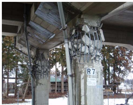
(b) 損傷度B1の被害（第一中曽根高架橋の端部柱）
