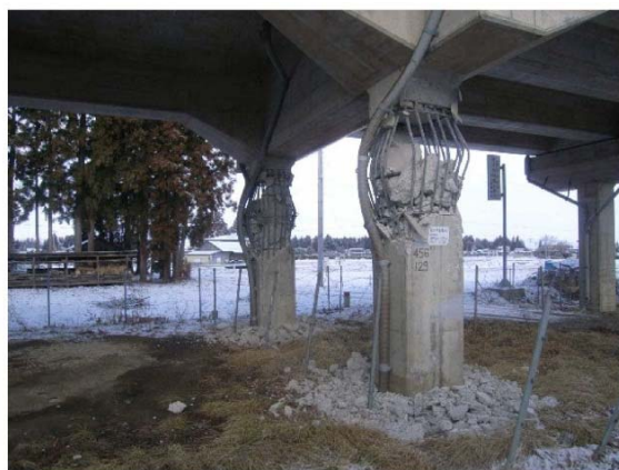
写真2 第一中曽根高架橋の損傷状況（起点側） 5)
