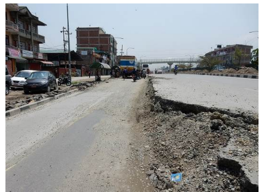
写真-5.2 道路縦断方向の段差（下り車線，終点側）
