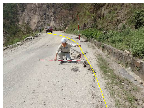
写真-3.7 地すべりによる路面変状
