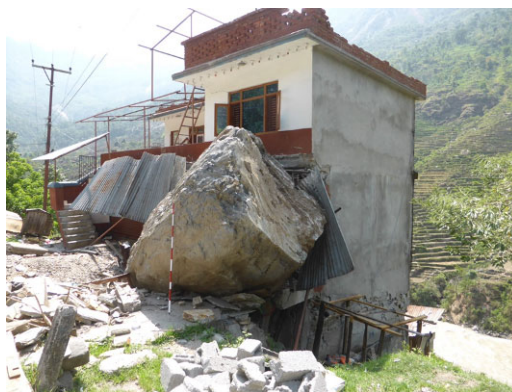
写真-3.5 落石の一例
