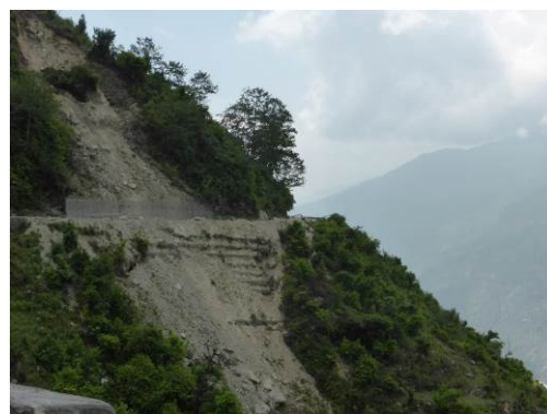
写真-3.3 表層崩壊の一例
