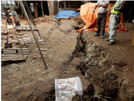
写真-5.4 道路北側の材木工場における地盤の亀裂・段差
