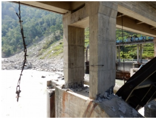
写真-4.5 門柱基部の曲げ破壊
