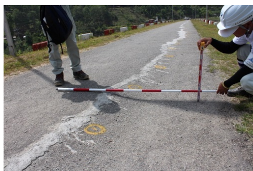
写真4.2 クレスト左岸上流側の沈下
