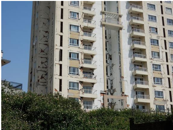
写真-6.4 高層マンションのひびわれ
