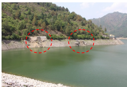
写真4.3 ダム湖法面の洗掘状況
