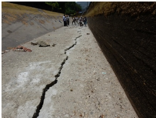
写真-4.6 開水路底版の亀裂
