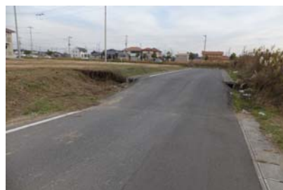
写真-2 砂利採取跡地縁で発生した段差
