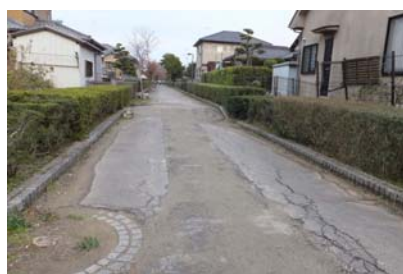
写真-3 砂利採掘跡地縁の段差が発生したために傾いた家屋
