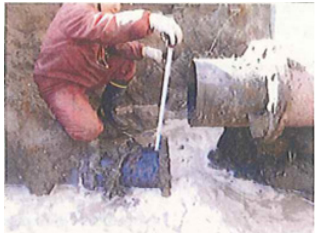
図-1 茨城県W浄水場における埋設管の脱管 3)
