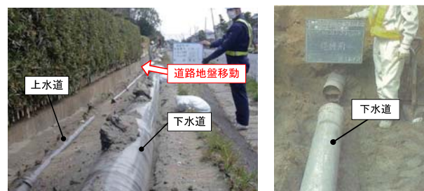
写真5 潮来市日の出地区の管路被害状況
