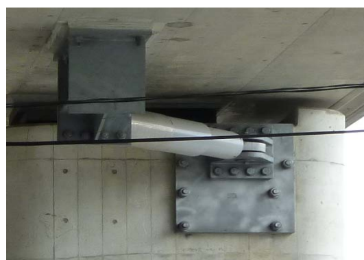
写真-1 水平斜め方向に設置した 制震デバイスの設置例
