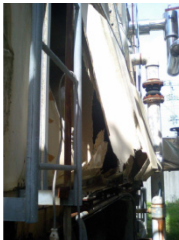
図-2 側板の被害 (a) 仙台市、受水槽、FRP製、設置年不明 (配管取付け部から破損が拡大している)
