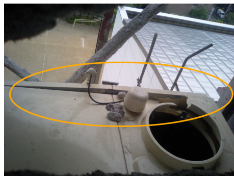
(b) 仙台市、高置水槽、FRP製、1987年設置
