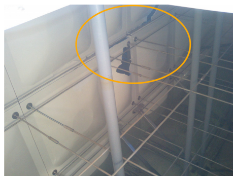
(b) 仙台市、受水槽、FRP製、1990年設置
