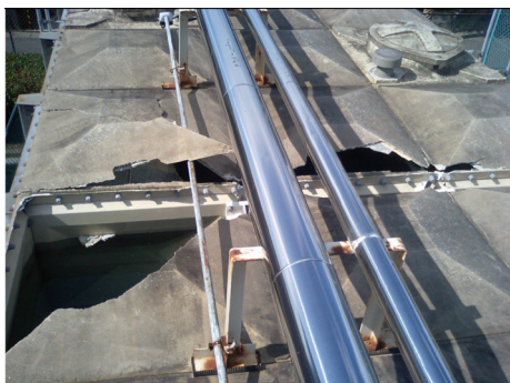
図-1 天板の被害 (a) 仙台市、受水槽、FRP製、1988年設置
