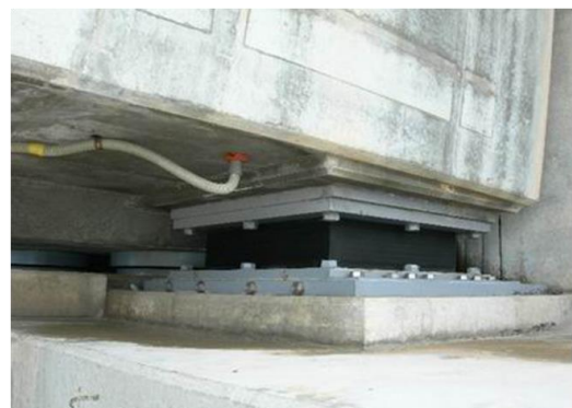
写真-1 橋梁に設置されたゴム支承の例
