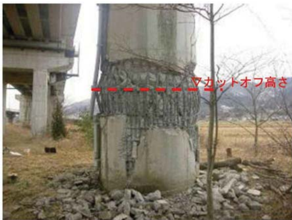
図-3 段落し部の損傷状況②（橋脚 No. 6）
