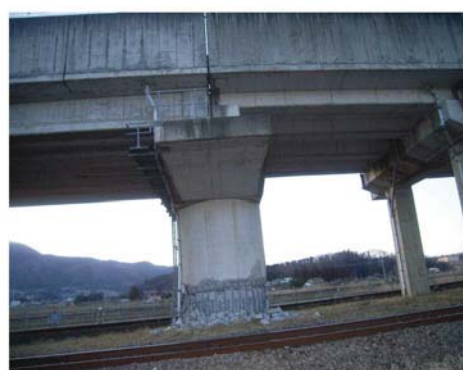
図-7 橋脚 No. 9 の損傷状況
