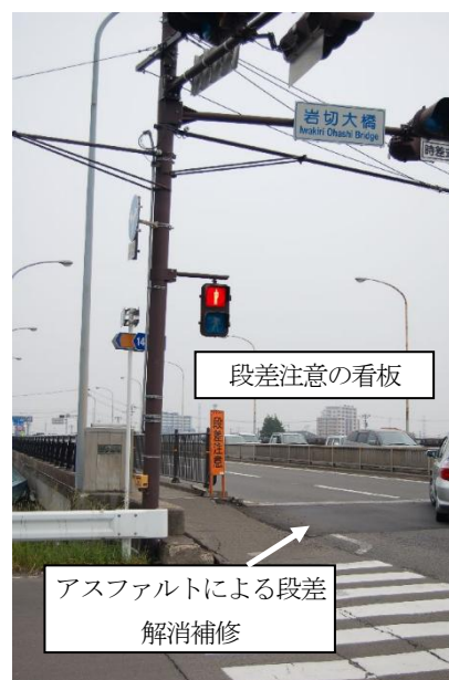
写真-1 橋台背面地盤沈下に伴う段差障害の例 (H23.6.5撮影)
