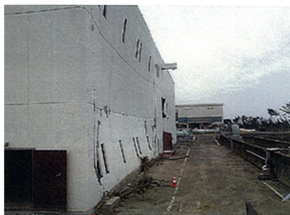
写真-1 ポンプ室外壁の損傷（仙台市建設局）
