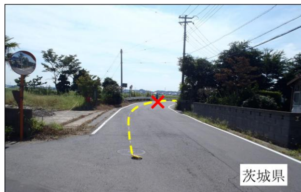
写真-1 曲線布設箇所の被災事例
