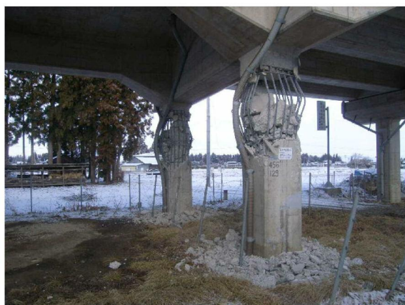
図-7 N s 高架橋の損傷状況（起点側）
