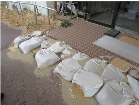
図-11 浪江町中央公民館入口に生じた段差と土のう (2013年4月2日撮影)。
