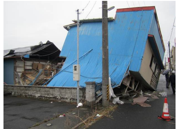
図-12 浪江町市街地の木造建物被災事例（被災度 D5） (2013年4月2日撮影)。
