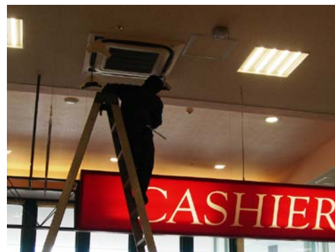
写真-5 破損した空調設備
