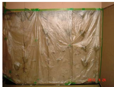
写真-6 剥がれ落ちた内壁
