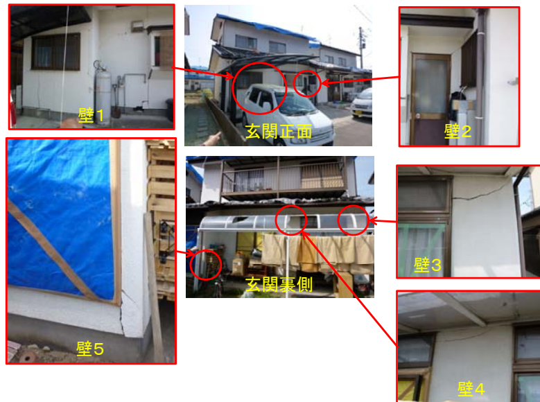
図-15 一部損壊Aの被害写真
