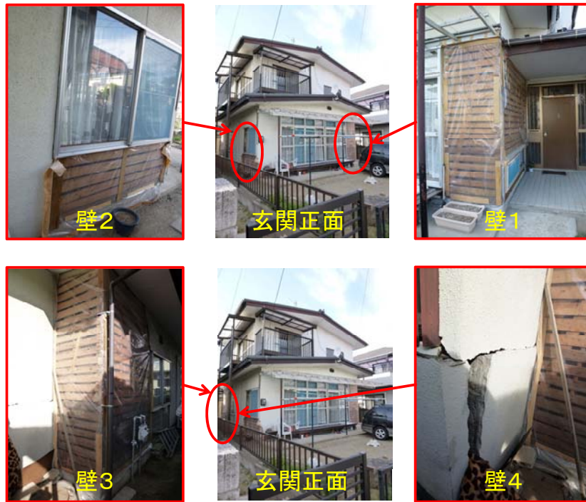
図-12 大規模半壊の被害写真
