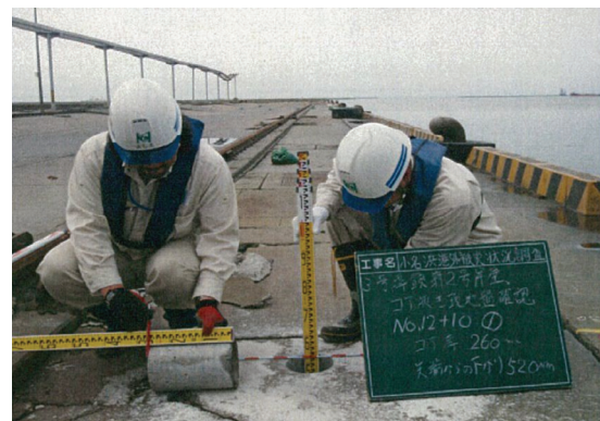
図-1 小名浜港3号ふ頭岸壁の被災後写真 2)
