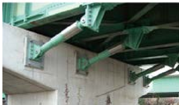
写真-1 鉛直斜め方向に設置した制震デバイスの設置例 6)
