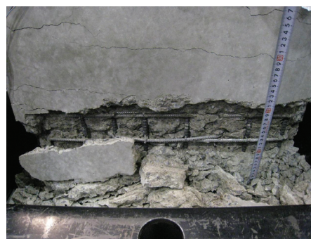
写真-1 東側柱の基部付近の損傷状態 5) (T400)
