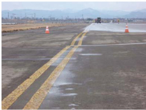
a) 県道周辺部（局所沈下）
