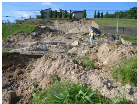
図-11 鶯沢工業高校の盛土・擁壁崩壊
