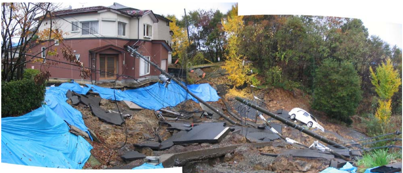
写真-5 盛土斜面崩壊の範囲が住家の基礎部分にまで及ぶ2004年新潟県中越地震による高町団地の被災状況 16)
