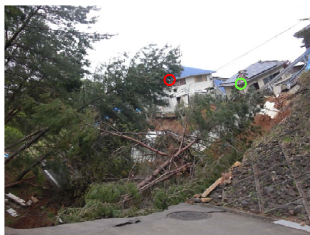
写真-4 福島市伏拝の宅地造成盛土の被災状況(2)
