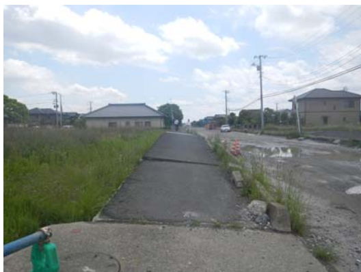
(a)歩道部における排水路の浮上
