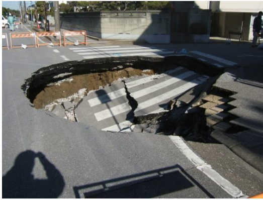
(a)道路の陥没状況
