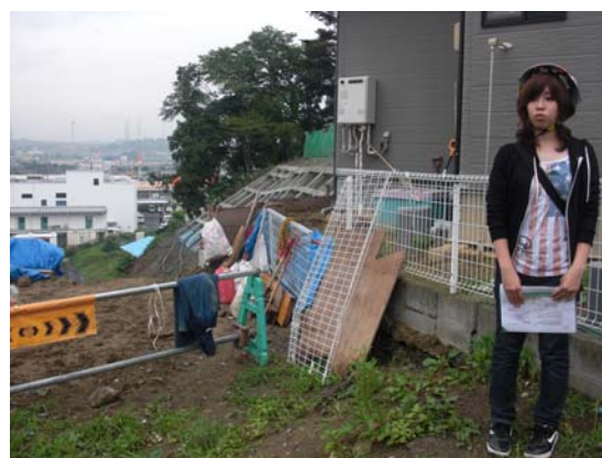
写真-1 南光台6丁目の盛土斜面の被災状況
