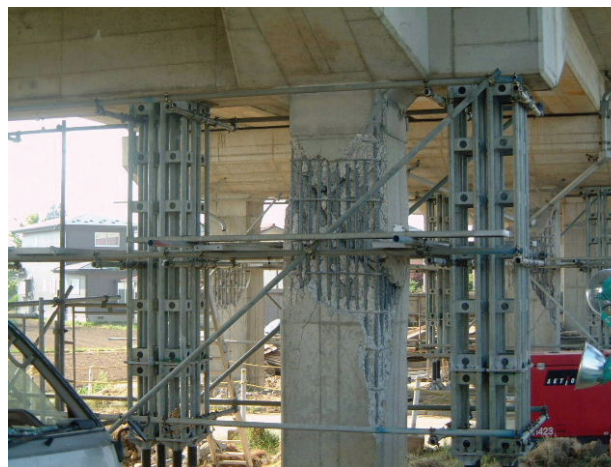
写真-1 2003年三陸南地震における愛宕高架橋の被災状況 4)
