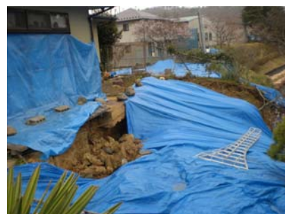
写真-1 館ニュータウン宅地被災状況
