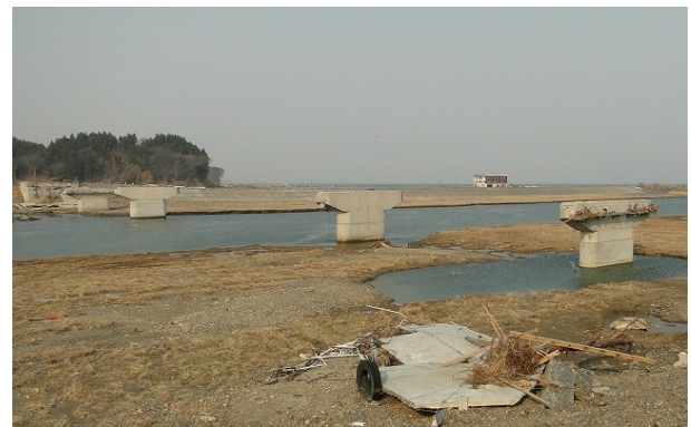
図-3 被災後の小泉大橋
