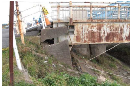
写真-5 路肩崩壊箇所でのケーブル被害
