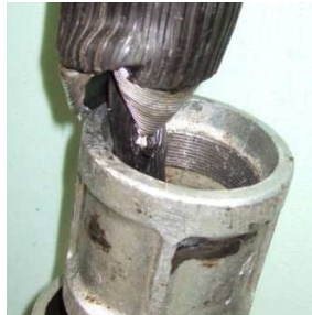
写真-8 屈曲SA管の状況
