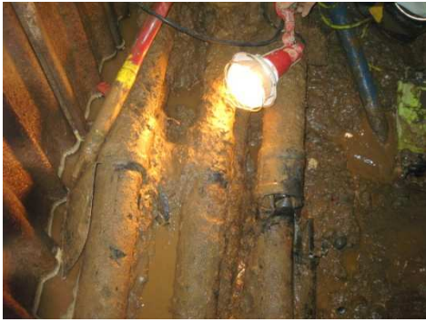
写真-1 管路折損離脱によるケーブル被害
