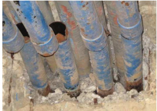
写真-4 路肩崩壊箇所でのケーブル被害
