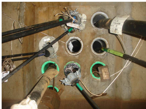
写真-3 路肩崩壊箇所でのケーブル被害
