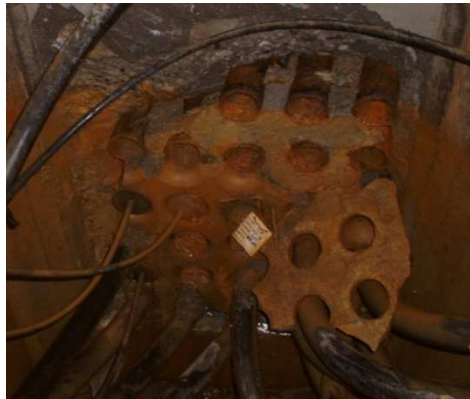
写真-2 ダクト突出によるケーブル被害
