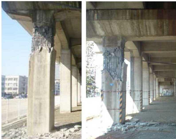
図-1 端柱の損傷例(起点方より撮影)
