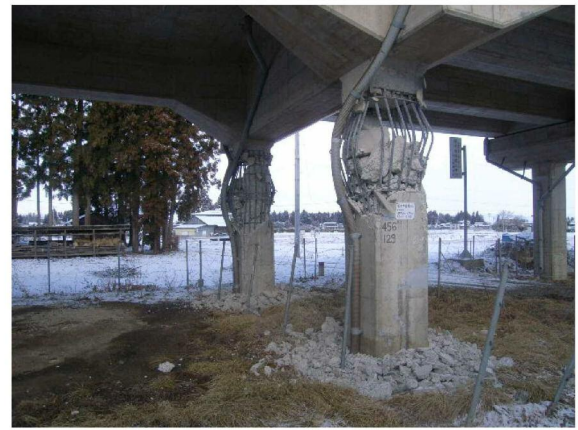
図-6 曲げ破壊した柱部材の損傷状況 (起点側)
